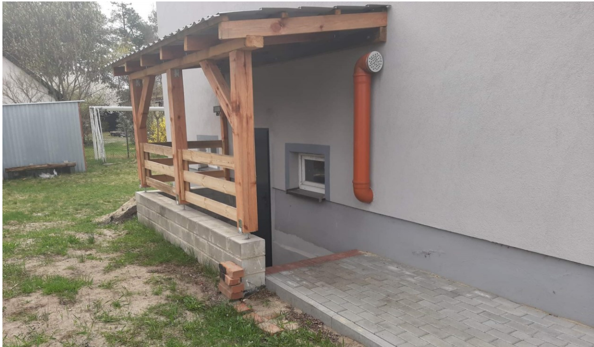
Rysunek 7-12 Wejście do kotłowni w świetlicy wiejskiej w Płazowie
