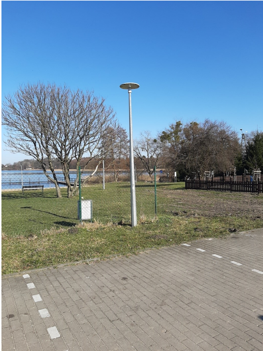
Rysunek 7-1 Zmodernizowane oświetlenie.
