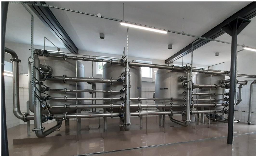
Rysunek 7-2 Zestaw filtracji w pomieszczeniu technologicznym.
