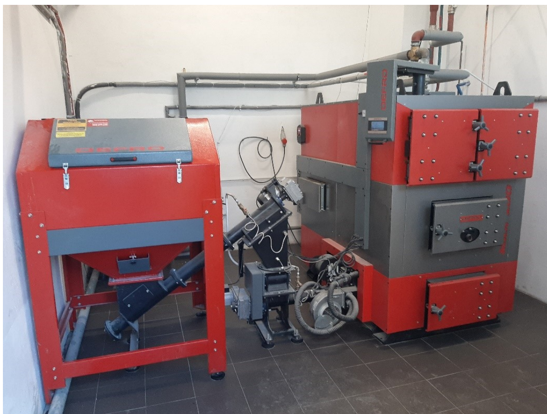
Rysunek 7-5 Kocioł na paliwo stałe w świetlicy wiejskiej w Bysławiu
